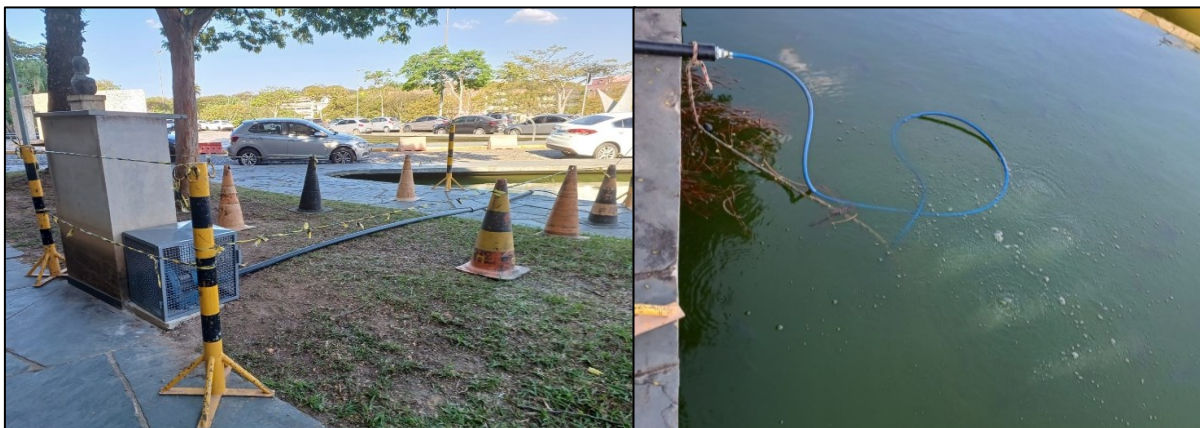
Figura 2: Instalação de compressor radial para complementar os níveis de oxigênio no Lago menor da Reitoria. O equipamento foi instalado em setembro de 2023, no intuito de evitar mortalidade de peixes em decorrência a baixos níveis de oxigênio na água. À esquerda, a foto mostra o equipamento instalado nas margens do lago; e à direita, a imagem destaca as microbolhas geradas pelo equipamento.
